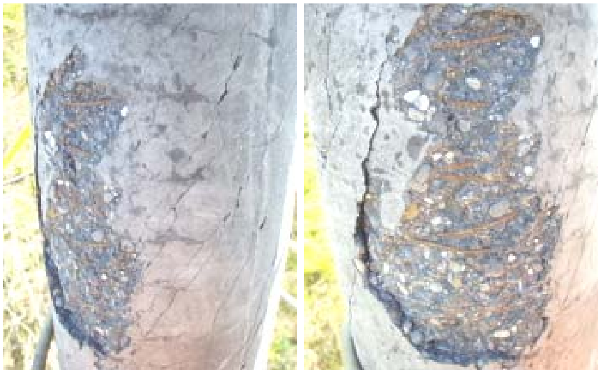
Abb. 10 Bei Betontragwerken ist es relativ schwierig grössere Torsionskräfte zu übertragen, weshalb die hauptsächlichsten Defekte auch Torsionsdefekte darstellen.
