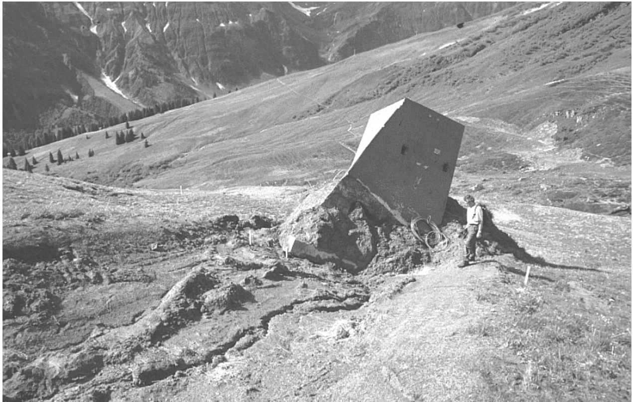
Abb. 4: Schneedruckschaden: Ein Mastfundament der Bergbahnen Elm wird durch die gleitende Schneedecke mehr als 8m weg gedrückt. Foto: S. Margreth, SLF.
