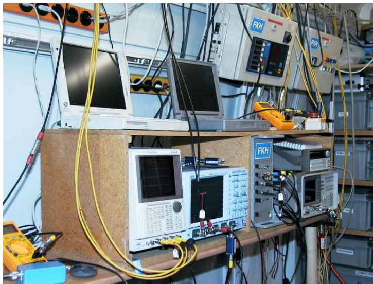
Abbildung 4 Gerätepark im FKH-Messwagen zur Erfassung von Teilentladungen an einem Transformator unter Vor-Ort-Bedingungen
