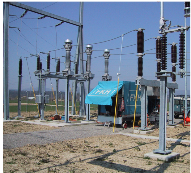
Bild 6 Mobile Erdschlussmessanlage der FKH, Anhänger mit der Messstrom-Speisung bestehend aus Frequenzumrichter, Anpasstrafo und kapazitiver Blindleistungskompensation. Der Messstrom wird über Erdungsgarnituren links hinten in den Freileitungsabgang eingespeist. Die Erdungstangen im Vordergrund dienen der Erdung des Schaltfelds zwischen Sammelschiene und Leitungsabgang
