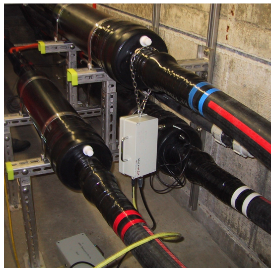
Abbildung 15: TE-Messung an einer Crossbondingmuffe mit eingebautem TE-Sensor
