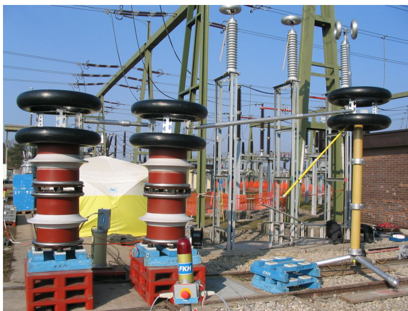
Abbildung 1: Modulare Seriemesstechnik (Einspeisung in die GIS über ein Trafokabel)
