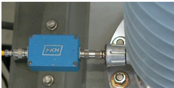
Abbildung 30 Koaxialer Anschluss eines HF-Wandlers (TE-Sensor) an den Messbelag der Durchführung
