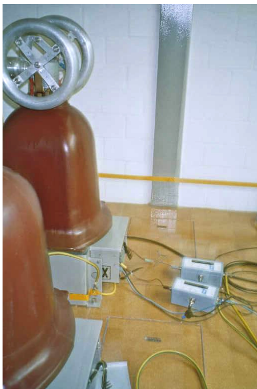
Abbildung 20 Einspeisung der Prüfspannung in die Sekundärwicklungen des Spannungswandlers und TE-Ankopplung an den Stromwandlerwicklungen und der Hochspannungswicklung
