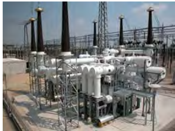
Abbildung 18: Felderweiterte AIS-Anlage in Italien mit 420/550 kV T 155 GIS-Feld
