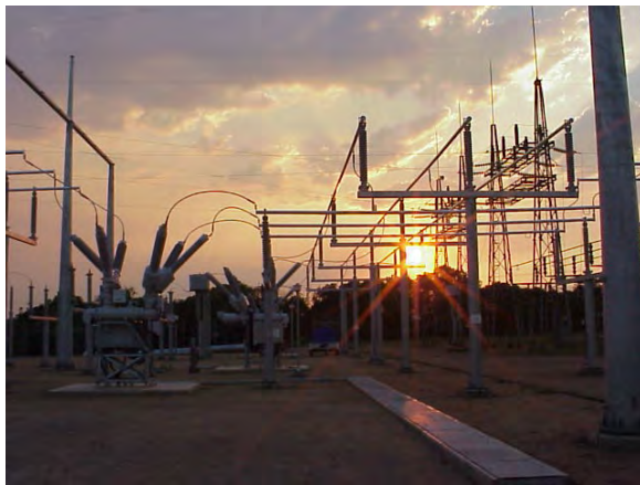
Abbildung 17: umgebaute 145-kV-AIS-Anlage in Australien mit B65 hybrid GIS Optigim Modulen
