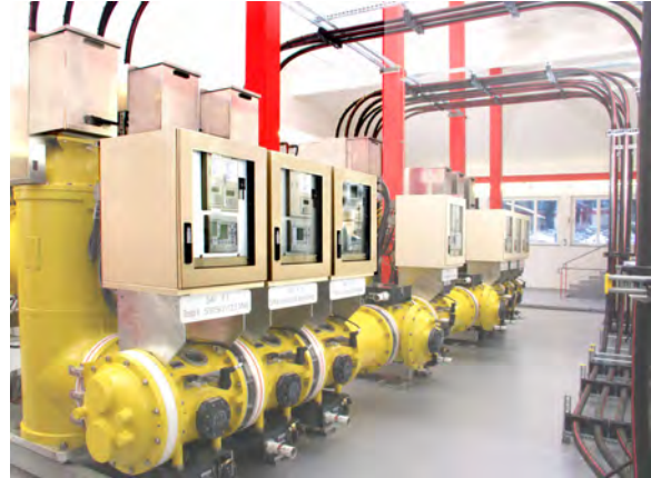
Abbildung 6: neue 50-kV-GIS Schaltanlage
