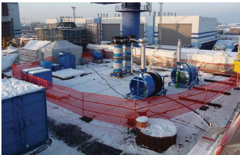
Abbildung 2: FKH-Prüfanlage aufgestellt auf dem Deck einer Konverter-Plattform
