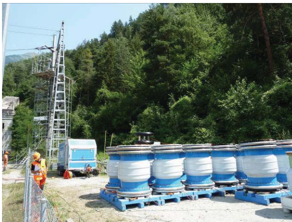
Abbildung 2: Prüfaufbau vor Nordportal des Simplontunnels in Brig Links: Kabelendverschlüsse Rechts: 11 Serie-Resonanz-Drosseln der FKH zur Erregung einer Phase mit Wechselspannung
