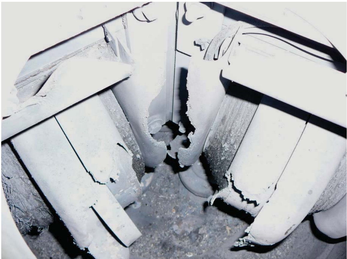
Abbildung 1: Durchschlag eines 125-kV-Spannungswandlers nach 19 Jahren Betrieb; Anlass für eine dielektrische Überprüfung der gesamten GIS-Anlage.
