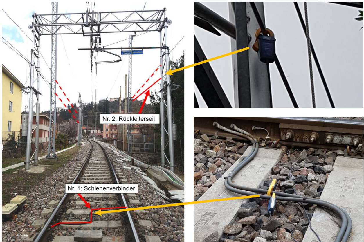
Abbildung 4: DC-Strom-Messungen in Rückleitern der SBB in Luino nördlich der Systemtrennstelle
