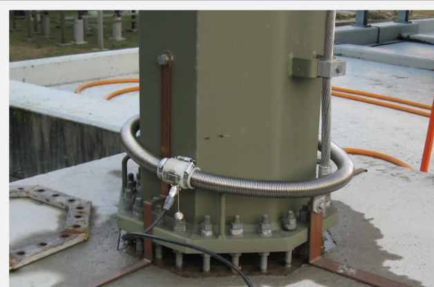
Bobine de Rogowski pour la mesure des courants de mise à la terre dans les mâts
