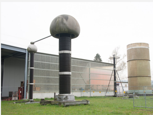
1000-kV-Prüftransformator in der Versuchsstation Däniken
