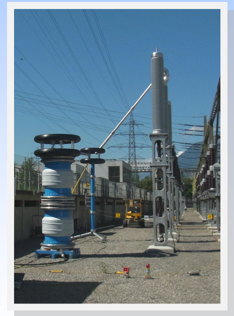
Hochspannungsresonanzprüfung an einer 275-kV-Kabelverbindung
