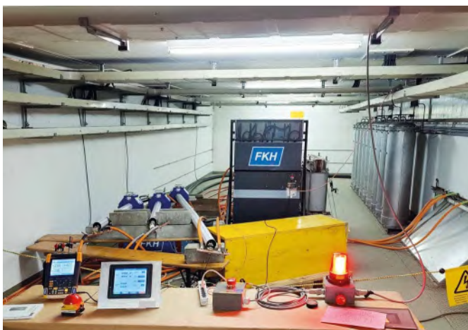
Abbildung 1: 3-phasige Einspeisung mit Umrichter auf die Kabel im UW Drahtzug
