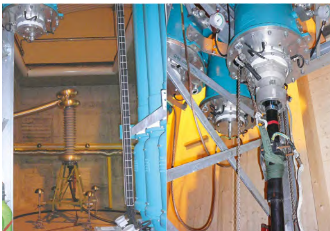
Abbildung 2: Kabelprüfadapter für die Prüfung der 245-kV-GIS Grimsel (sehr beschränkte Platzverhältnisse in der Kaverne)
