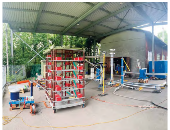
Abbildung 2: Hivoduct-Prüfpole und Blitzstoss-Prüfaufbau
