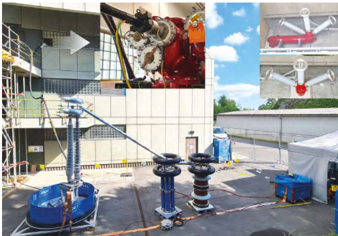
Abbildung 1: Kabelprüfadapter für die Prüfung der 123-kV-GIS Horw (Rechts oben: Abschirmung der schwer zugänglichen Freiluft-Durchführungen in der Trafobox)
