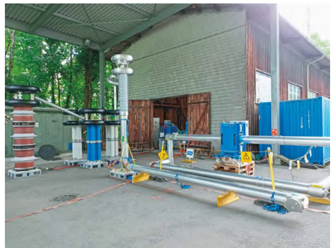
Abbildung 1: Hivoduct-Prüfpole und Wechselspannungs-Prüfaufbau
