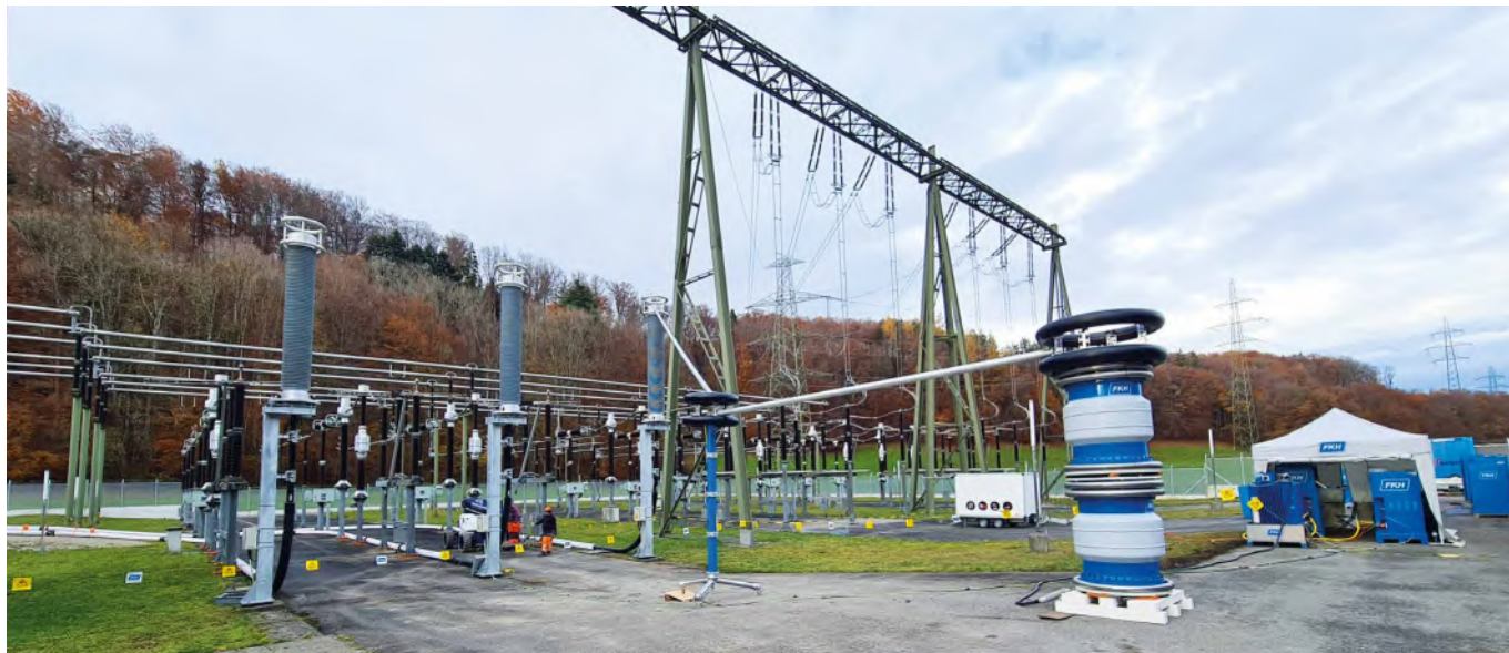
Abbildung 2: Prüfanlage und Freiluft-Kabelendverschlüsse im Unterwerk Bickingen
