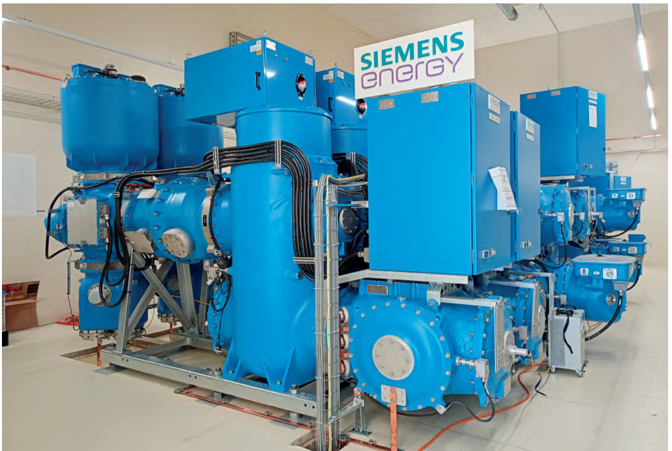
Abbildung 1: Gasisolierte Schaltanlage der 145-kV-Spannungsebene mit «Clean Air» als Isoliergas der Primeo Energie AG
