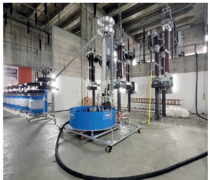
Abbildung 1: Prüfanlage mit Prüfkabel, geprüfte Kabel im Hintergrund oben
