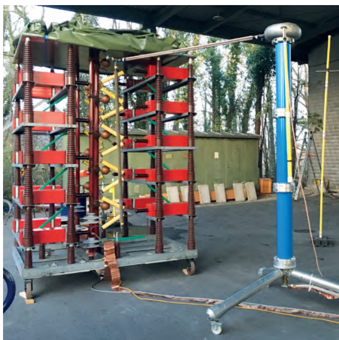
Abbildung 1: Bisheriger FKH-800-kV-Stossgenerator im Einsatz in Niedergösgen
