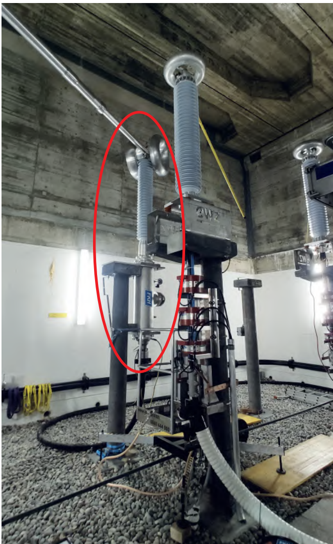
Abbildung 2: Einspeisung mit Prüfmuffe und Durchführung (rot eingekreist)
