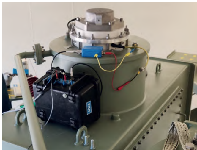
Abbildung 2: Teilentladungsauskopplung über einen kapazitiven Abgriff einer Connex-Buchse
