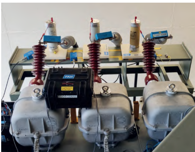
Abbildung 1: Einspeisung über Steckdurchführungen Connex 3 auf der Unterspannungsseite des Transformators
