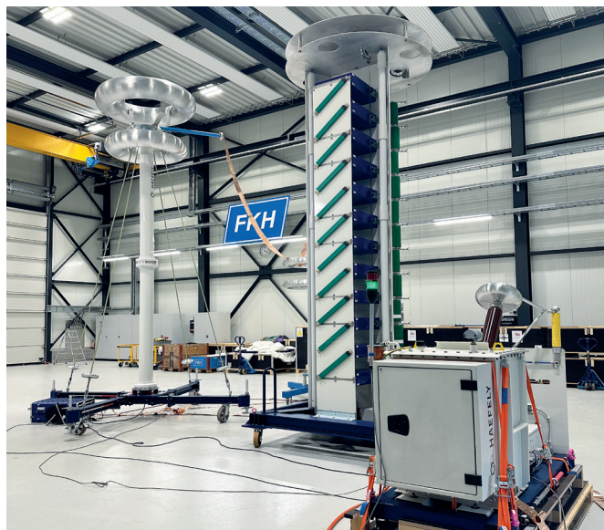
Abbildung 25: Modular aufgebauter Stossgenerator (im Bild mit 12 Stufen). Im Vordergrund die Ladeeinrichtung, links der 1600-kV-Spannungsteiler
