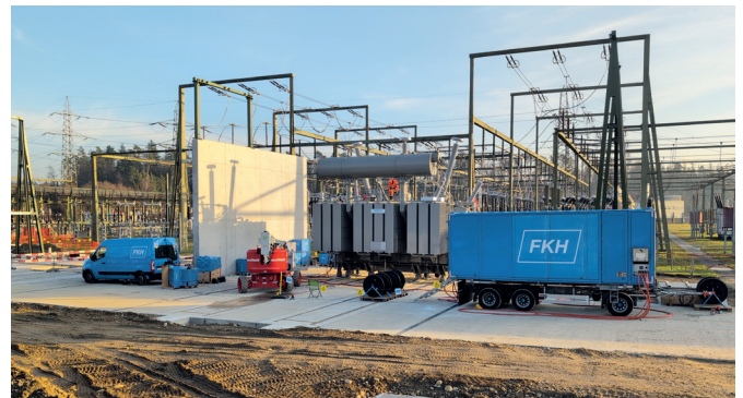
Abbildung 16: Teilentladungsmessung mit mobilem Messbüro (im Transporter) und Prüfanhänger
