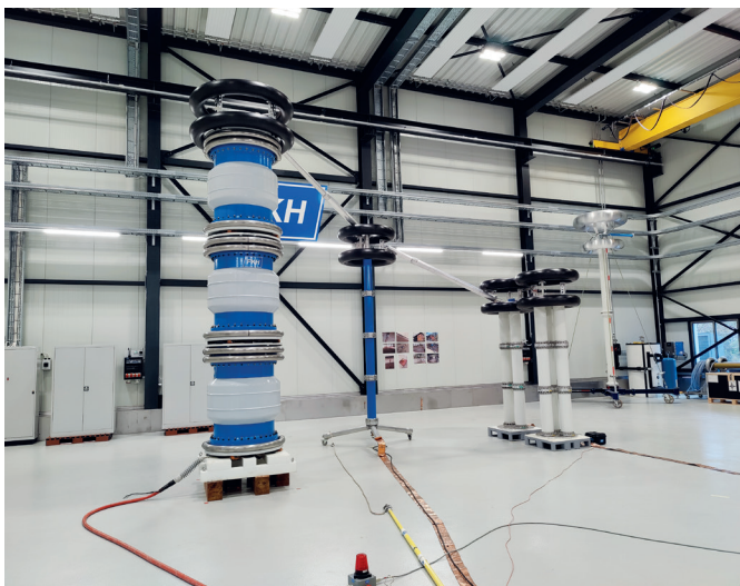
Abbildung 24: Seriersonanzanlage (von links: Turm mit drei 80-H-Drosseln in Serie, kapazitiver Spannungsteiler, Zusatz- und Koppelkondensatoren) für eine interne Prüfung in der grossen Prüfhalle
