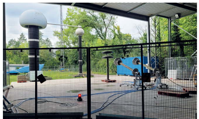
Abbildung 30: Gedeckter Vorplatz der Prüfhalle mit einem Prüfaufbau für Step-Tests, gespeist von dem 1-MV-Prüftransformator (im Hintergrund)
