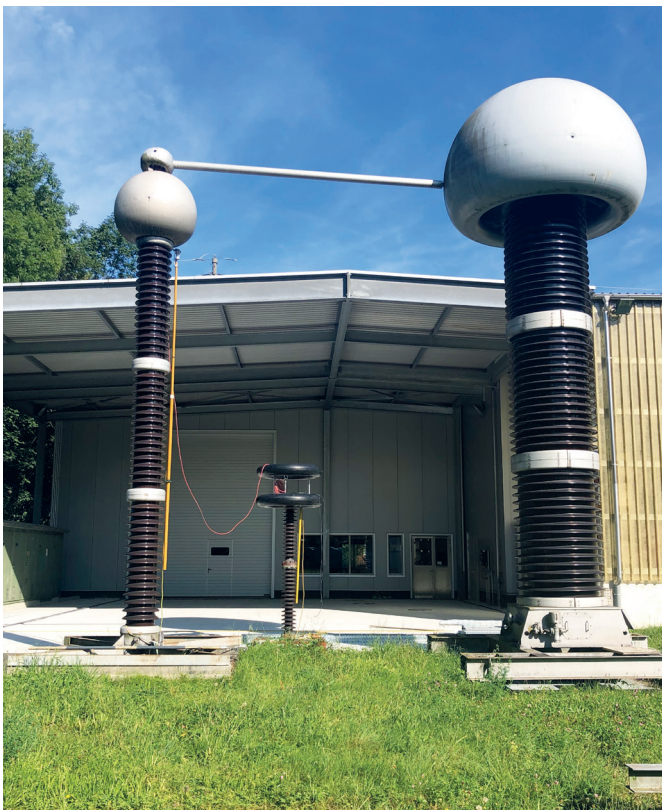
Abbildung 27: 1-MV-Prüftransformator der Firma Moser Glaser AG
