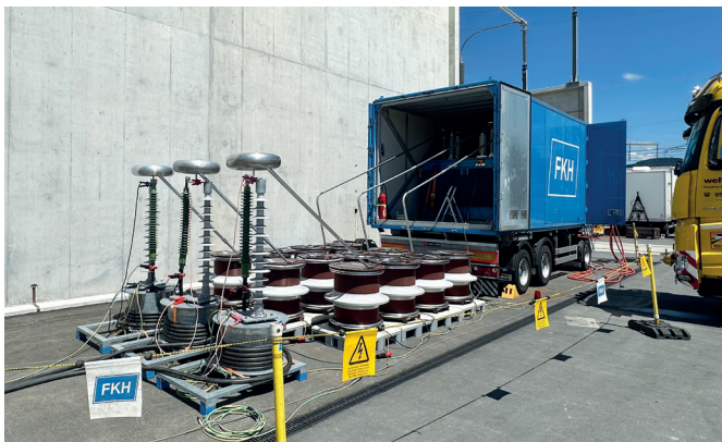
Abbildung 15: Hochspannungsprüfanlage inkl. Kompensationsdrosseln und Kabeln für die Prüfung einer grossen Leistungstransformatorbank
