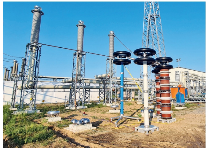
Abbildung 8: Hochspannungsprüfanlage für eine 420-kV-GIS-Prüfung (Spannung via Freiluftdurchführung)
