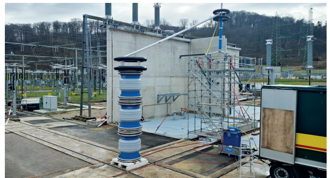
Abbildung 6: Resonanzprüfanlage für ein 220-kV-Kabelsystem mit Teilentladungsmessung
