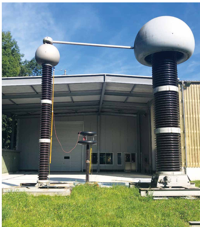
Illustration 27: Transformateur d'essai de 1 MV de la société Moser Glaser AG
