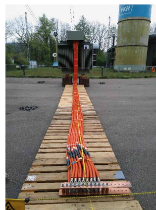
Illustration 29: Mesure du champ magnétique sur un transformateur de distribution de 3,15 MVA
