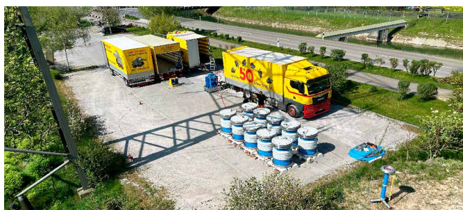
Illustration 5: Installation de résonance série pour un essai sur câbles sans mesure des décharges partielles
