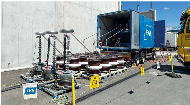
Illustration 15: Installation d'essai haute tension comprenant des inductances de compensation et des câbles pour le contrôle d'un grand groupe de transformateurs de puissance
