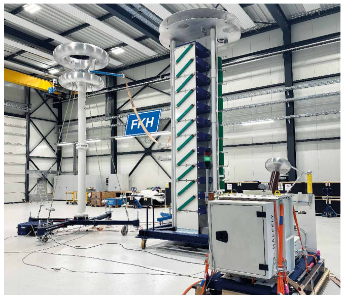
Illustration 25: Générateur de chocs de conception modulaire (avec 12 étages sur la photo). Au premier plan, le dispositif de charge; à gauche, le diviseur de tension de 1600 kV
