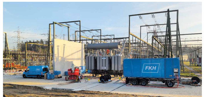
Illustration 16: Mesure des décharges partielles à l'aide d'un laboratoire mobile (installé dans une camionnette) et d'une remorque d'essai
