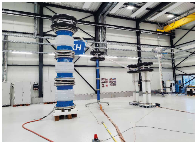
Illustration 24: Installation de résonance série (de gauche à droite: tour comportant trois inductances de 80 H montées en série, diviseur de tension capacitif, condensateurs supplémentaire et de couplage) destinée à un essai interne dans le grand hall d'essais
